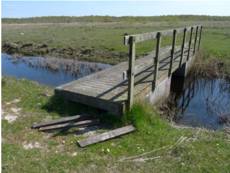
Figur 90. Her er opstemningsbrædder fjernet på et større stigbord i omr. 4a, hvilket betyder en lavere vandstand en der rent faktisk er muligt.
